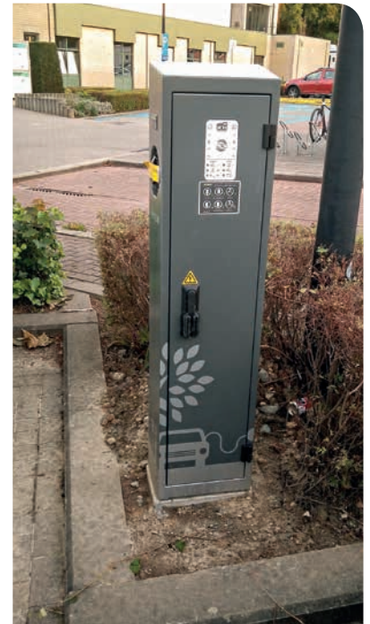
De laadpaal aan GC Colomba
