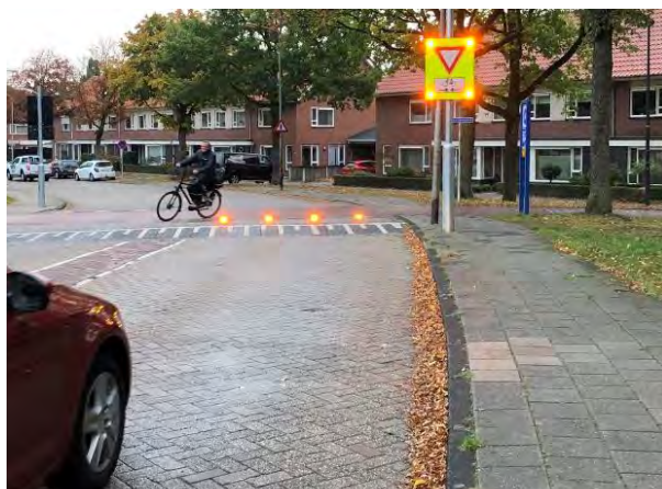
Figuur 117: voorbeeld LED signaleringssysteem (bron: https://www.sysconnect.nl/ )
